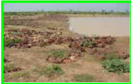
Protection mécanique inefficace contre l'envasement du bassin
