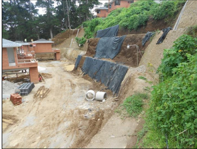
Imagen 10: Taludes sin protección, Concepción, mayo 2012.
