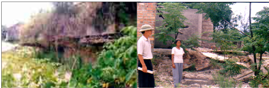
Ảnh 2: Cát chảy ở Lệ Thủy (Quảng Bình) năm 1999, làm trơ móng của một trạm bơm (trái) và phá sập ngôi nhà gạch ba gian của người phụ nữ này (phải)
